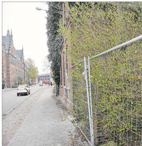
Ein Schandfleck in bester Lage: An der Ubbo-Emmius-Straße verfallen eigentlich benötigte Wohnhäuser.
