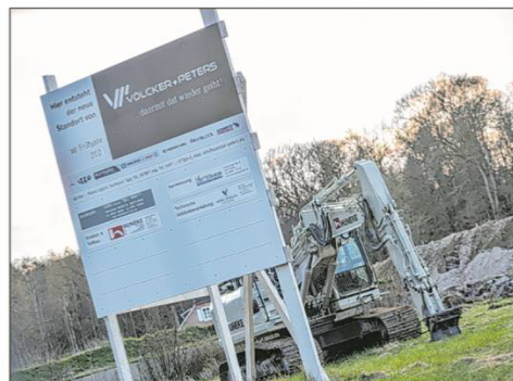
Ein Bagger steht schon einmal da. Auf dem ehemaligen Zoogelände in Logabirum entsteht bald Neues. BILD: ORTGIES
