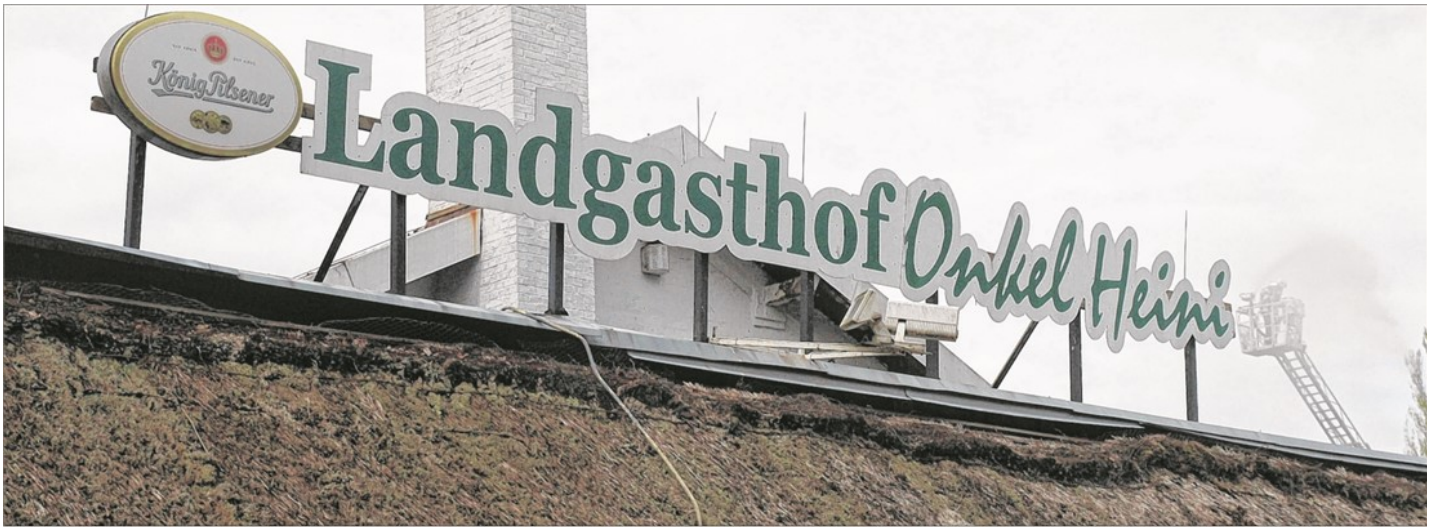
Die Tage für den Landgasthof „Onkel Heini“ sind gezählt. Der Abbris des Gebäudes steht bevor.
