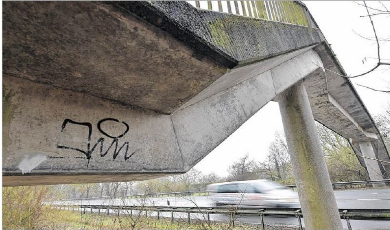
Ist rund 50 Jahre alt und muss ersetzt werden: die Brücke über den Stadtring in Leer.
