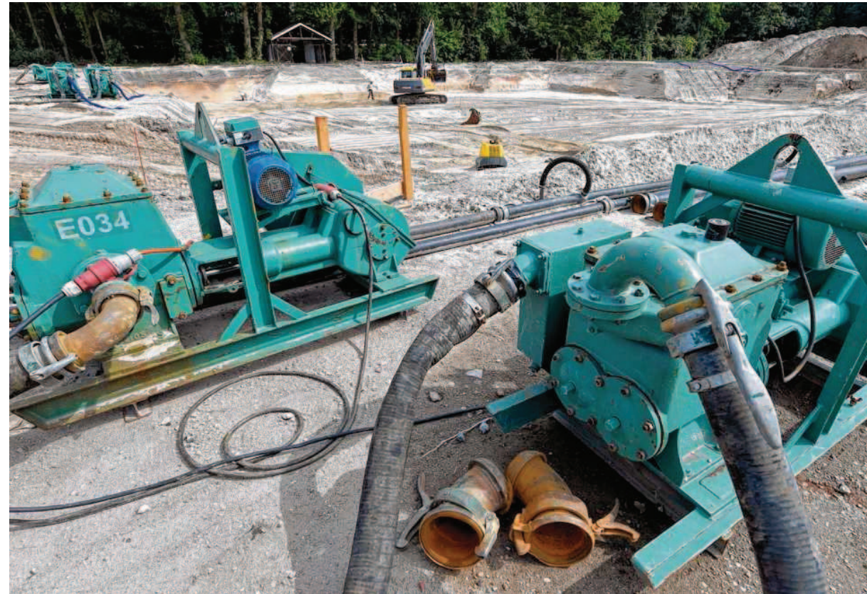
Die Baugrube für den Neubau ist bereits ausgehoben. Mehrere Pumpen laufen auf Hochtouren und sollen das Grundwasser in den nächsten Wochen in die Kanalisation ableiten.
